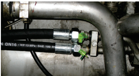
Conexiunea sistemului de măsurare diferențială de debit înalt la instalația pre-existent.
