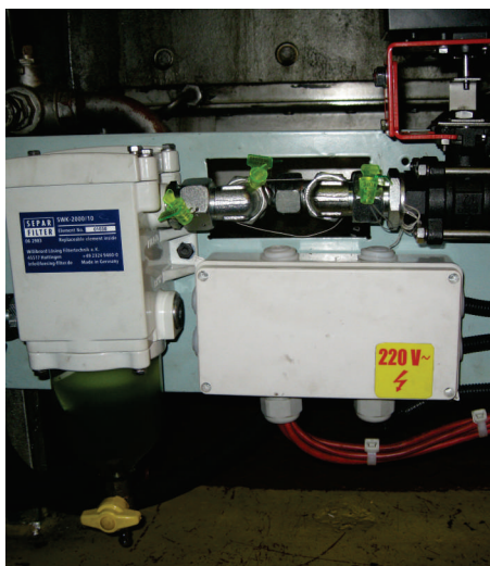
Pre-filtrarea și panoul electric secundar de comunicații al sistemului diferențial
